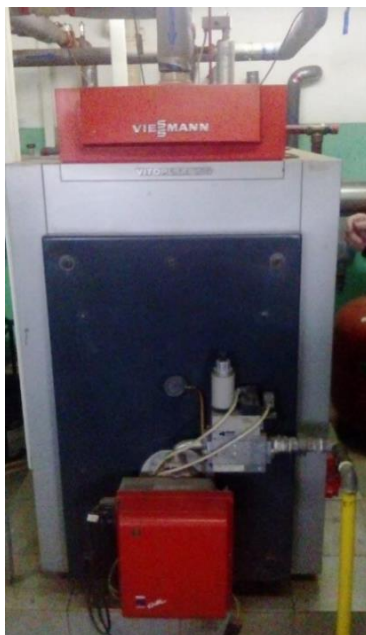
fot. 5 Istniejący kocioł gazowy
